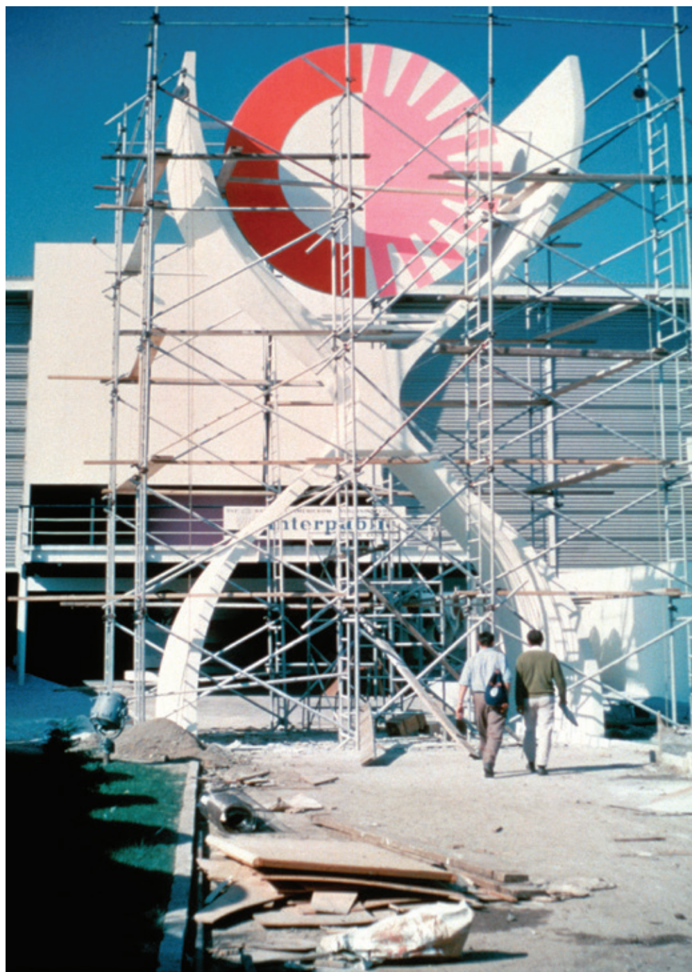
Gráficos para el pabellón de Estados Unidos en la Feria Internacional de Zagreb (proceso de construcción)—Graphics for the United States Pavilion at the International Trade Fair in Zagreb (construction process), 1962
